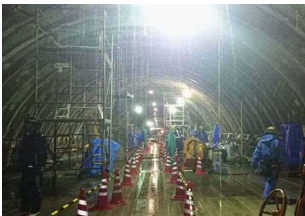
写真-3 減水対策施工前の状況
