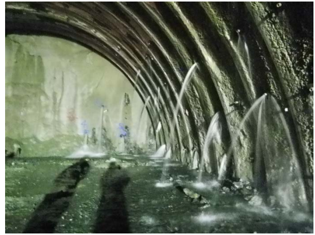
写真-2 トンネル掘進後の壁面からの湧水状況
