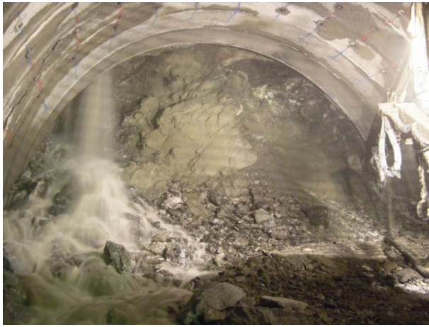
写真-1 低速度帯付近の掘削時の大量湧水状況
